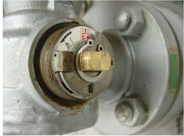
安全弁元弁（キャップを外した状態）
