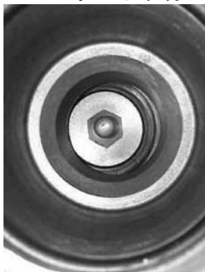
写真4 事故品元弁の軸ズレの状態
