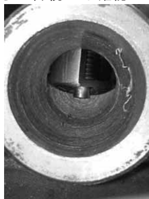
写真5 事故品元弁の状態（戻っていない）
