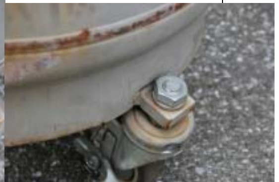
写真 キャスターの損傷状況
